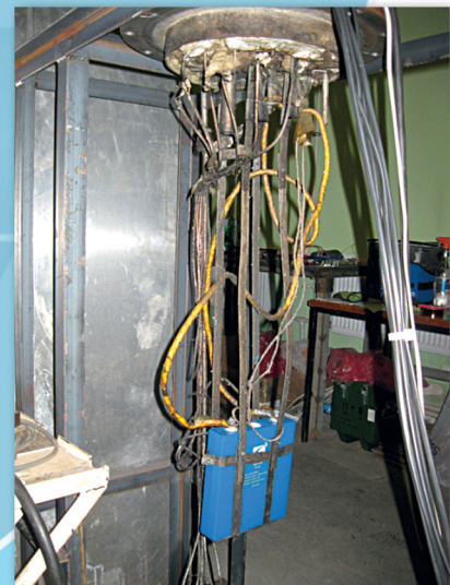
Рис. 4. Аккумулятор, готовый к установке в испытательную камеру Fig. 4. Li-ion battery ready for installation to testing chamber
